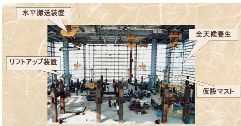
図 6-21 清水建設ビル自動化システム「スマートシステム」の内観
