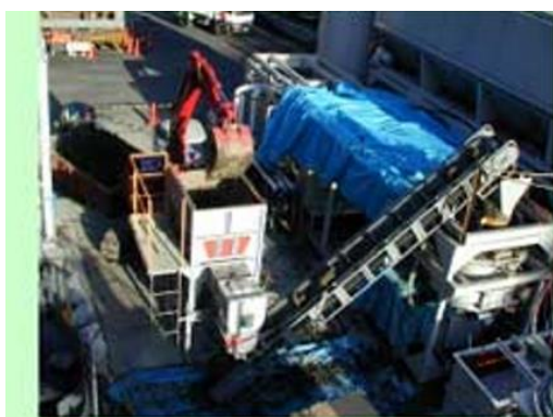
再生安定液製造設備
